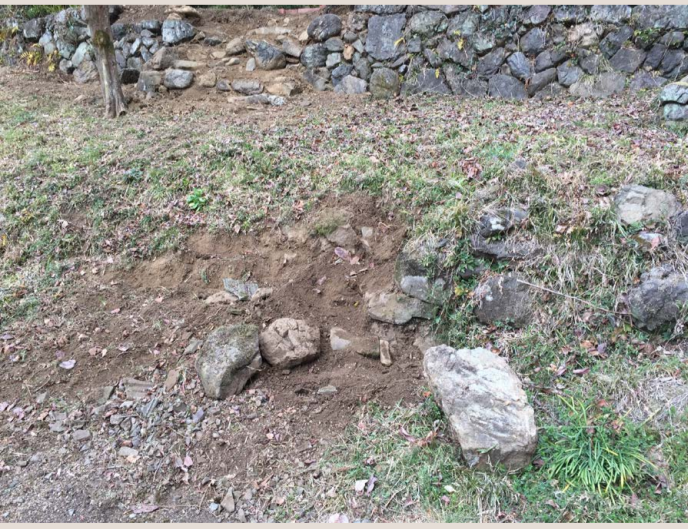
崩れてしまった石垣
